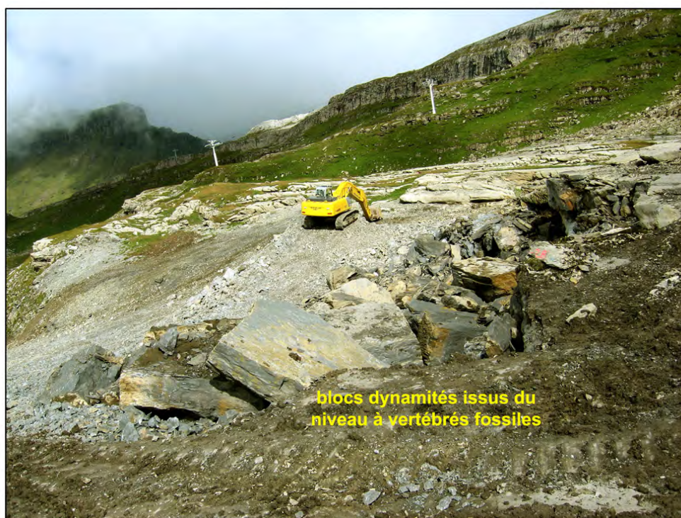
Figure 5 : Destruction partielle du gisement des Perdrix durant l'année 2005 (état au 28/08/2005).
